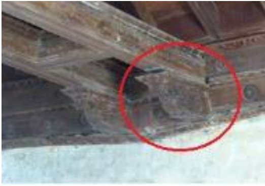
Figura 16. Deslocamento do apoio sob o tirante 2 (T2), no eixo 2.
