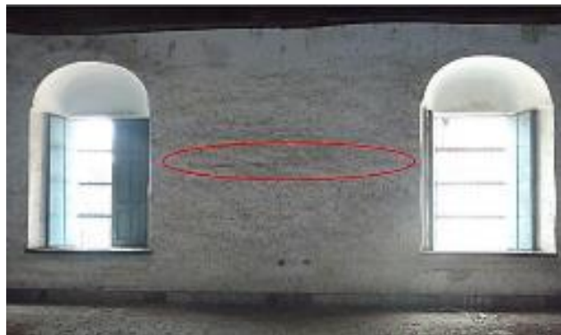
Figura 4. Fissuras horizontais na parte inferior da parede (eixo 1).
