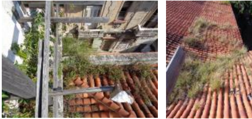
Figura 26 e Figura 27. Plantas invasoras no telhado do Coro Alto.
