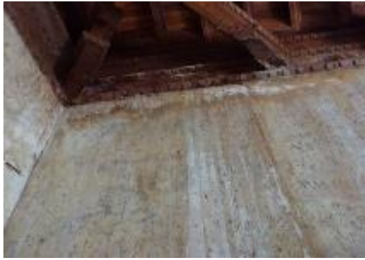
Figura 9. Parede no eixo A com escorrimentos
