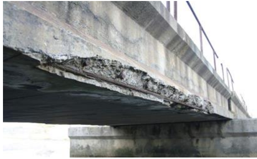
Figura 1. Danos causados por corrosão em uma ponte de concreto exposta à brisa marinha (cloretos) próxima à costa da Cidade do Cabo na África do Sul.
