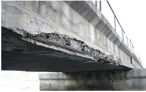
Figura 1. Daños causados por corrosión en un puente de concreto expuesto a la brisa marina (cloruros) cercano a la costa de la Ciudad del Cabo en África del Sur.
