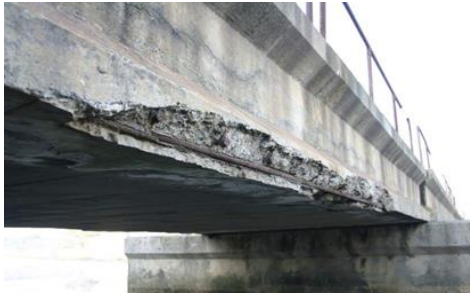
Figura 1. Daños causados por corrosión en un puente de concreto expuesto a la brisa marina (cloruros) cercano a la costa de la Ciudad del Cabo en África del Sur.
