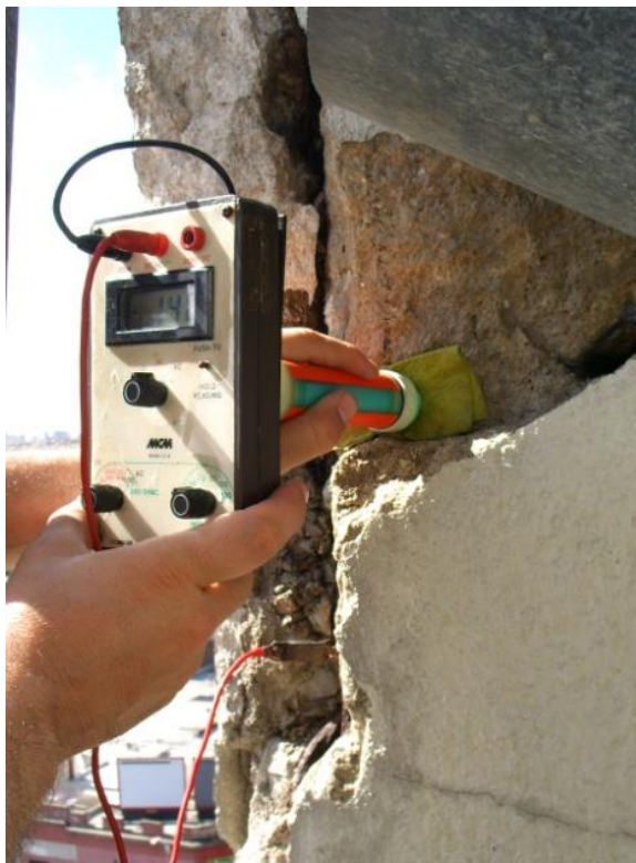
Figura 7. Ensaio de potencial de corrosão utilizando eletrodo de Cu/CuSO 4 (ASTM C 876, 1999).
