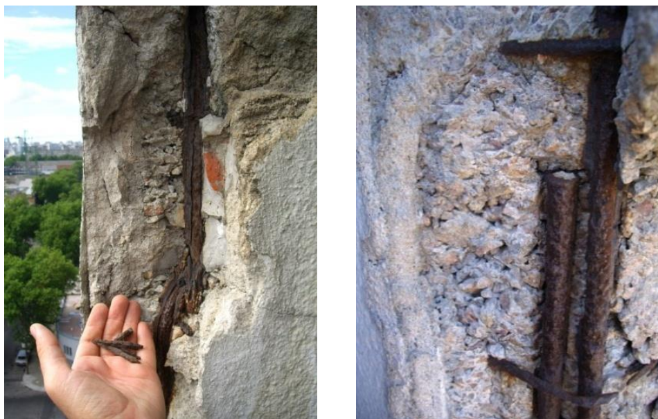
Figura 14. Pilares decorativos com corrosão acentuada em área com concreto de alta porosidade.
