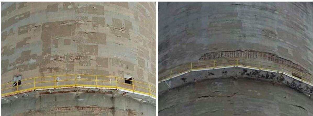
Figura 3. Observam-se armaduras expostas, corrosão, delaminações de concreto em forma de retângulos; Zonas de reparo localizadas realizadas anteriormente.
