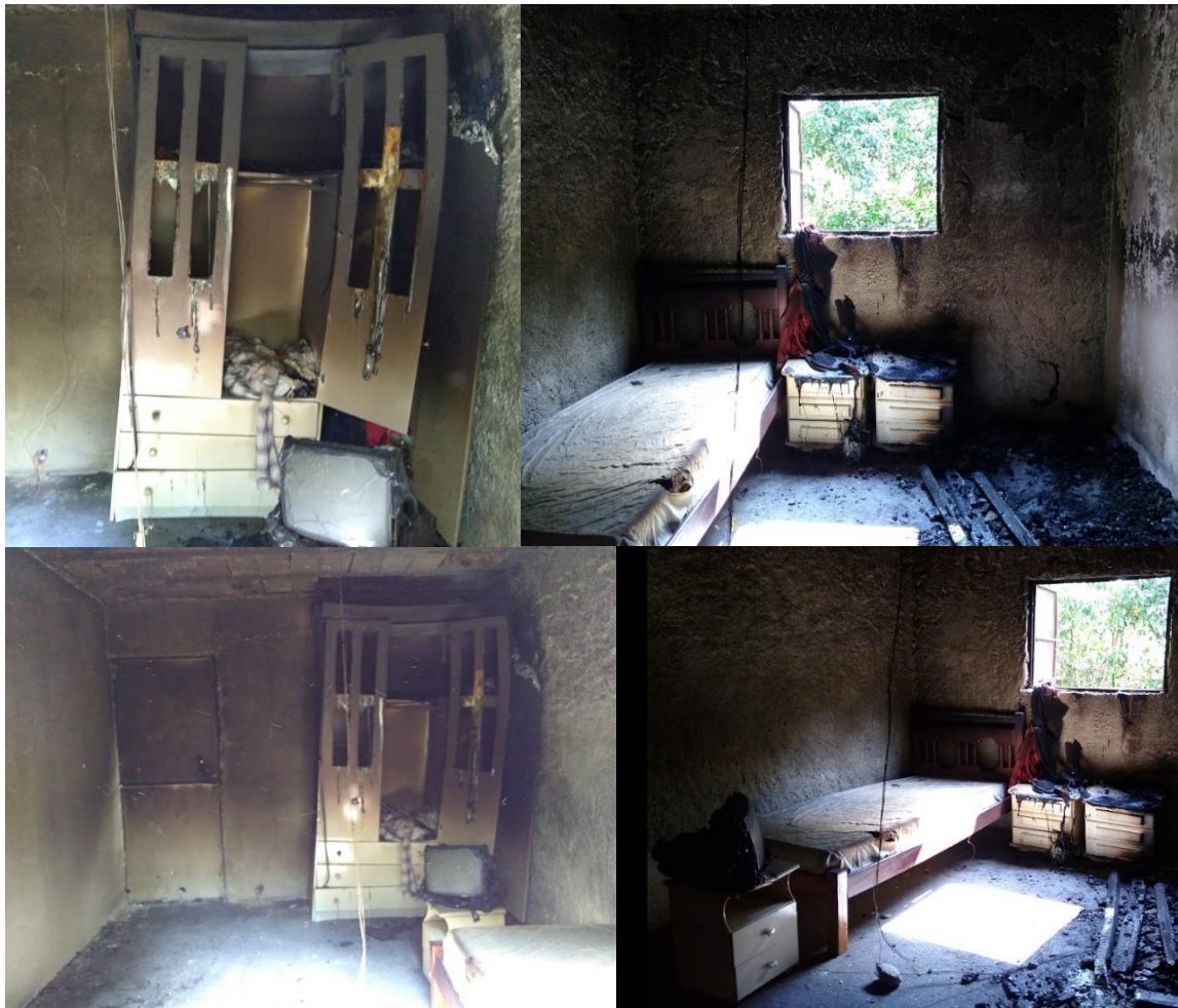
Figura 12. Imagens do cômodo após o incêndio.
