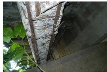
Figura 5. Armaduras expuestas y oxidadas en los largueros, exhibiendo inclusive estribos rotos.
