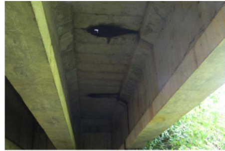
Figura 10. Drenaje dañado provocando infiltración y manchas de humedad en la losa entre largueros
