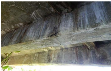
Figura 4. Presencia de eflorescencias, desprendimiento del recubrimiento de concreto y manchas marrón-rojizas consecuencia del proceso de corrosión de las armaduras.
