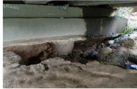
Figura 12. Presencia de Erosión en la fundación.
