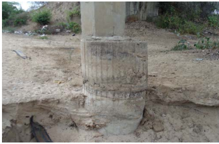
Figura 6. Erosión de la fundación y gran excentricidad del pilar con relación al pilote.
