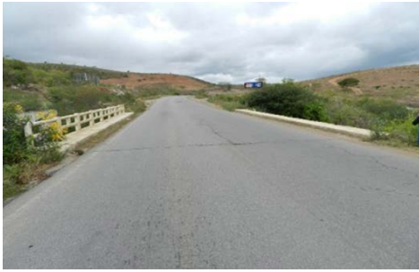
Figura 9. Ausencia de barandas lateral del puente
