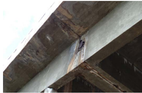
Figura 7. Accesorio de apoyo metálico en un diente Gerber con visibles daños y infiltraciones.
