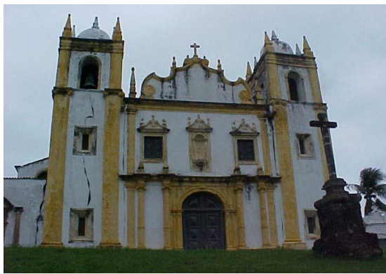
Figura 3. Daños Estructurales en la Iglesia do Carmo a mediados del 2000. Fuente: Acervo Público de Olinda.
