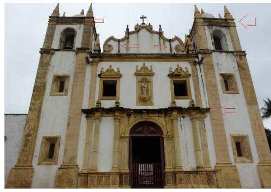
Figura 4. Daños actuales en la Iglesia do Carmo. Fuente: Autores.
