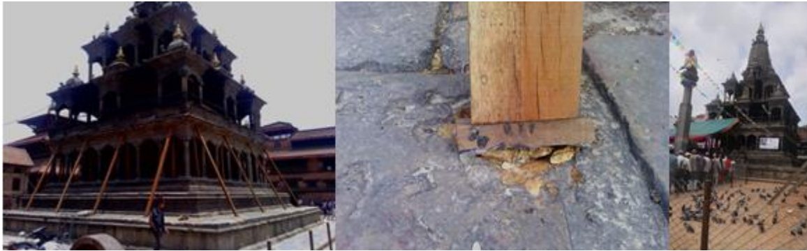
Figura 6. Krishna Mandir em Patan, danificado com esforços de proteção pós-terremoto
