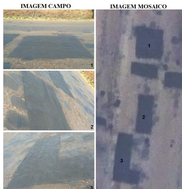
Figura 10. Bacheos profundos en las proximidades de la entrada a la Urbanización Santa Helena.
