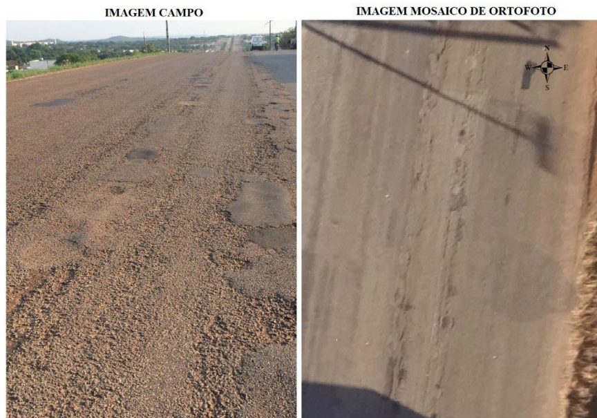
Figura 8. Desgastes superficiales en la entrada de la ciudad de Palmas - TO.
