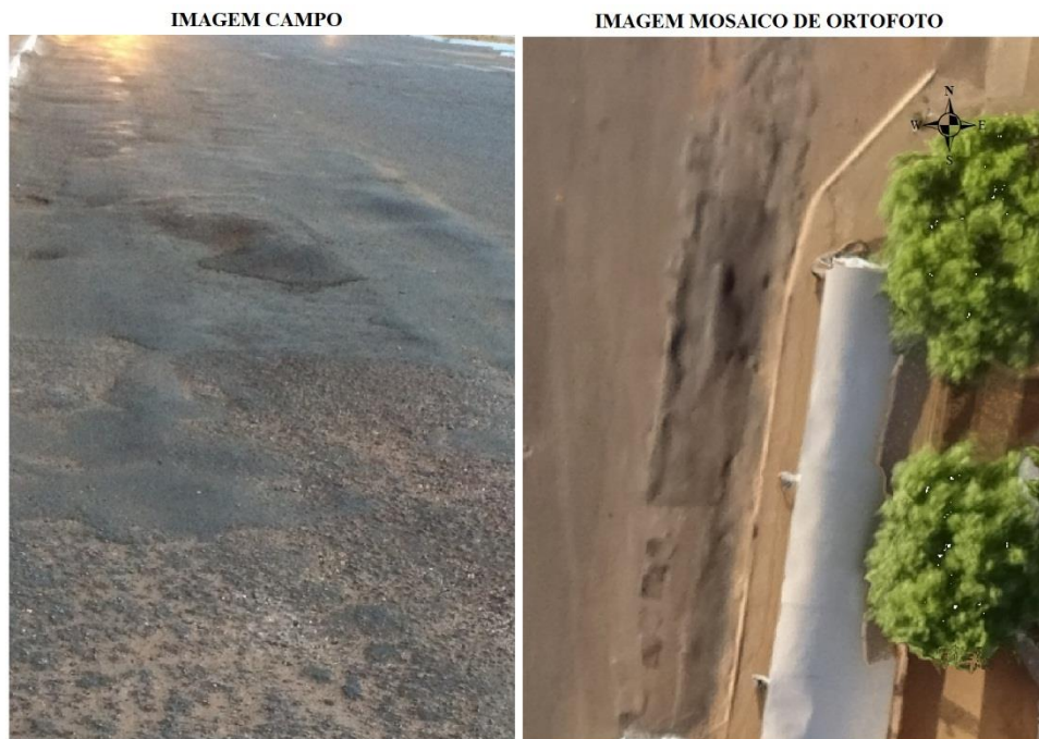
Figure 6. Afundamentos e solevamentos em trecho de tráfego pesado.
