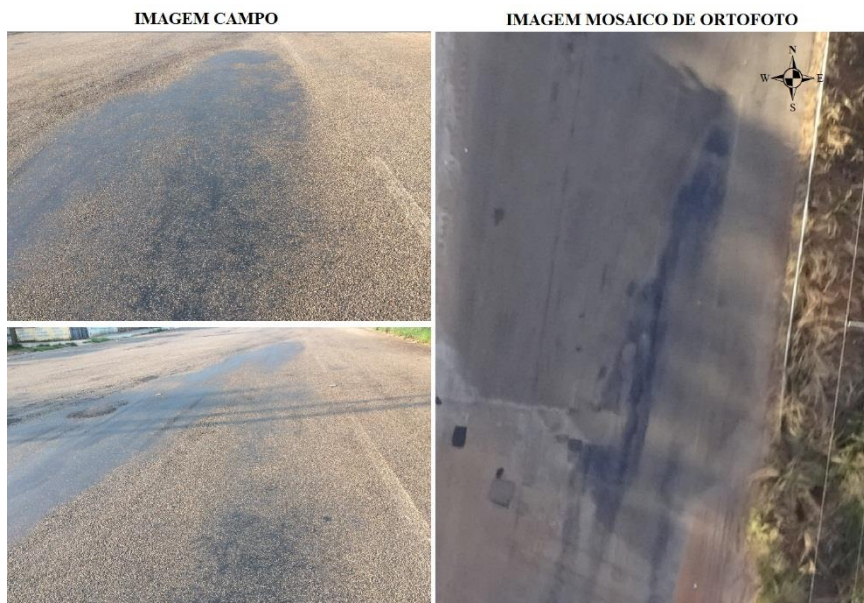
Figura 9. Exsudação em trecho próximo ao bairro Taquaralto.
