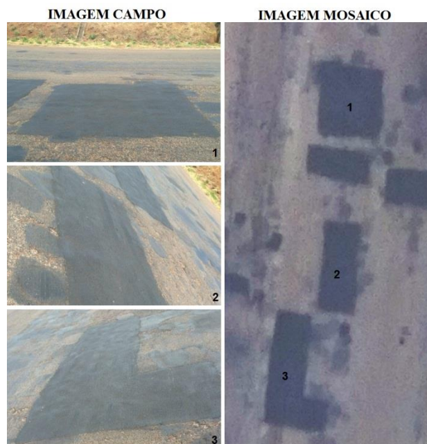
Figura 10. Remendos profundos nas proximidades da entrada do bairro Santa Helena.
