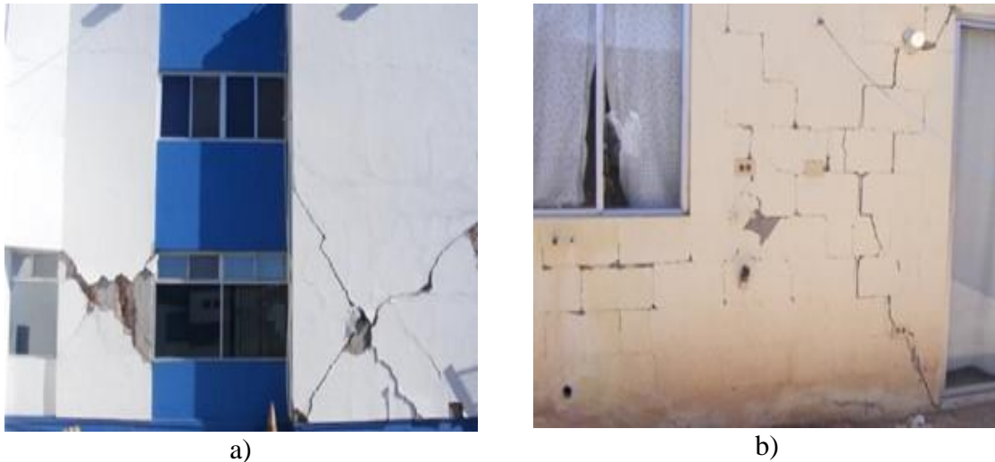
Figura 1. Danos às paredes de alvenaria no terremoto de Mexicali, na Baja California (Martínez e Martínez, 2010): a) Paredes perimetrais curtas, b) Casa-sala
