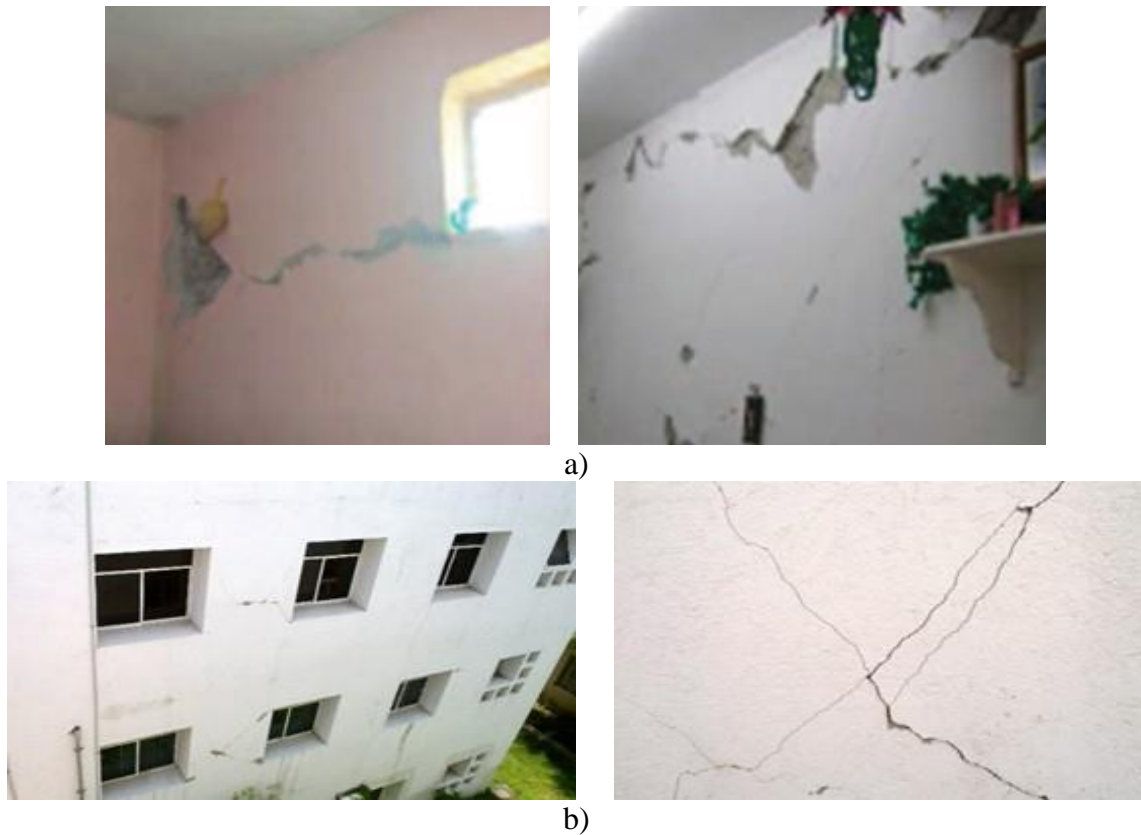
Figura 2. Danos nas paredes de alvenaria: a) Em Chilpancingo, Gro. (Arroyo-Matus et al., 2014), b) No Hospital Donato G. Alarcón de Acapulco, Gro. (Sánchez-Tizapa, 2013)
