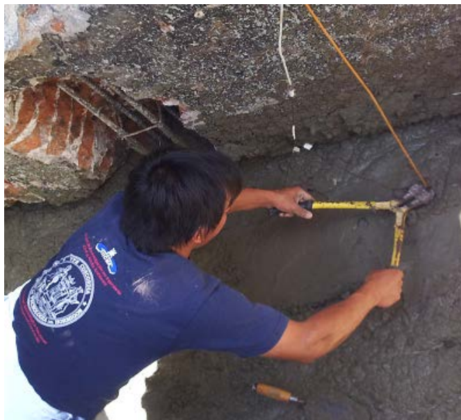
Figura 4. Colocación de sensores
