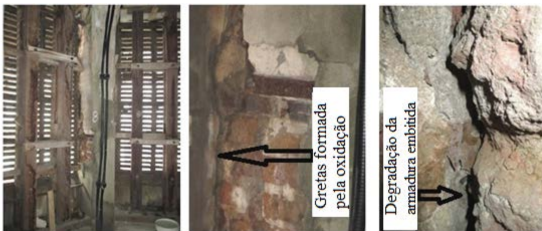
Figuras 4 a 6. Grietas causadas por la oxidación de los estribos de acero de las columnas
