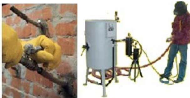
Figura 19. Proceso de inyección: colocación de acoples e inyección a través de bomba inyectora de epoxy
