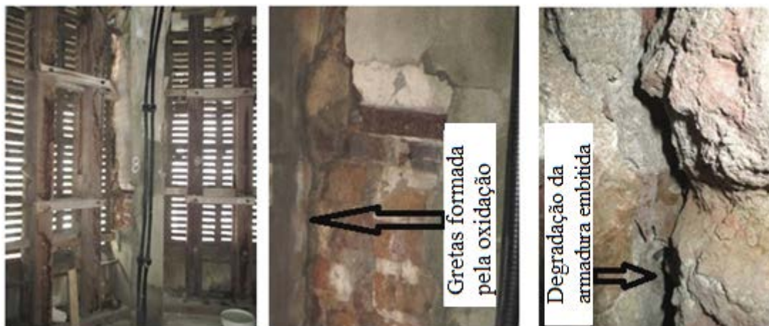
Figuras 4 a 6. Fissuras causadas pela oxidação das braçadeiras de ferro inseridos nas colunas
