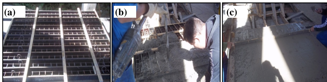
Figura 2. Fabricação das vigas de concreto armado - (a) Formas com armação prontas para concretagem; (b) Concretagem e adensamento com vibradores de imersão; (c) Nivelamento do concreto nas formas.
