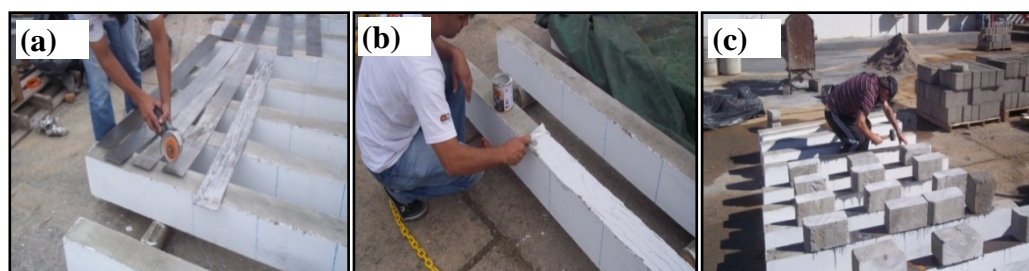
Figura 3. (a) Preparo das chapas; (b) Aplicação do adesivo estrutural epóxi; (c) Fixação e escoramento das chapas.
