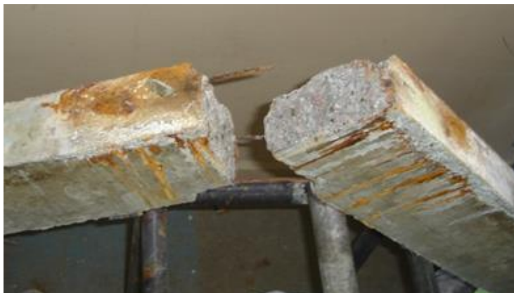
Figura 4. Viga V96 após o colapso.
