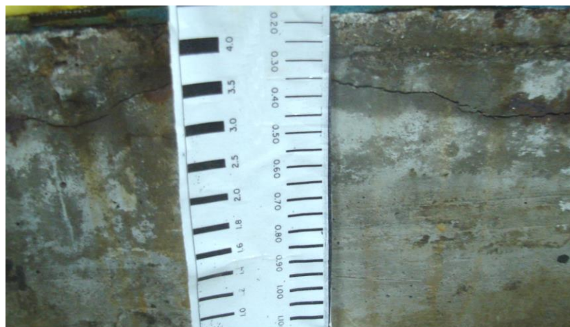
Figura 2. Medição da espessura de uma fissura gerada por corrosão acelerada.
