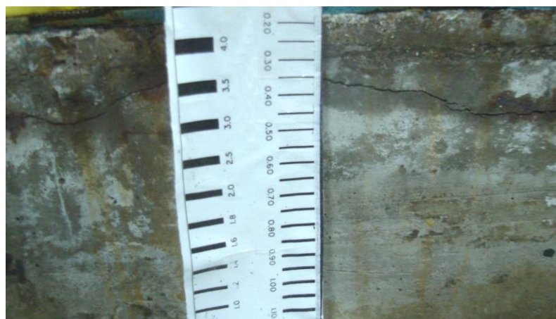
Figura 2. Medición del ancho de una fisura generada por corrosión acelerada.
