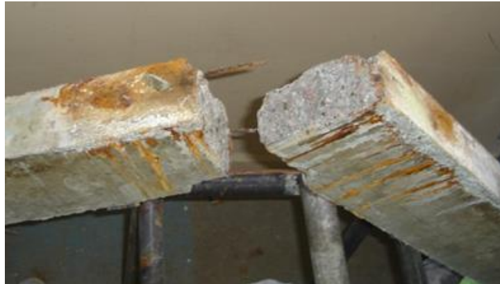
Figura 4. Viga V96 luego del colapso.
