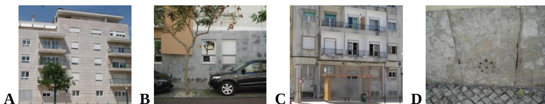
Figura 1. Condições de degradação dos revestimentos pétreos
