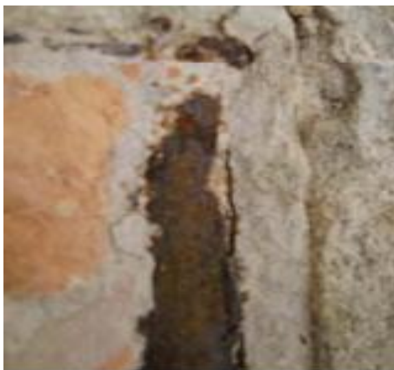
Figura 5. Armadura longitudinal corroída en los pilares.
