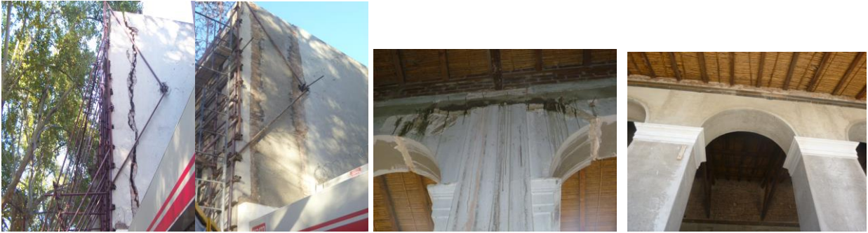
Figura 13. Fachada antes y después de la reparación de la mampostería. Arcos dañados y arcos reparados después de la consolidación
