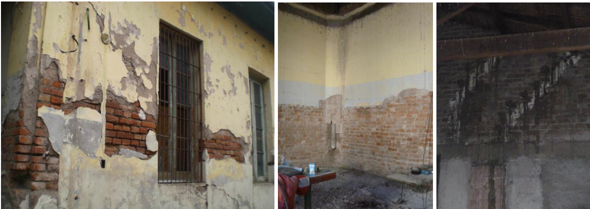
Figura 14. Estado de la mampostería previo a la intervención, estado de la mampostería luego de la recuperación de la cámara de aire y reparación de la mampostería con inyecciones y cosido.
