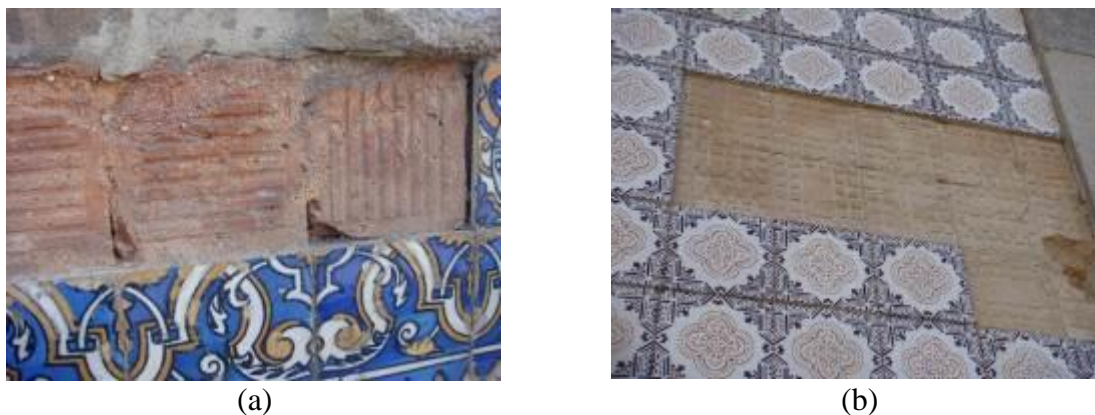
Figura 1. Regiões com destacamento de azulejos históricos em fachada de edificações da cidade de Ovar, Portugal.
