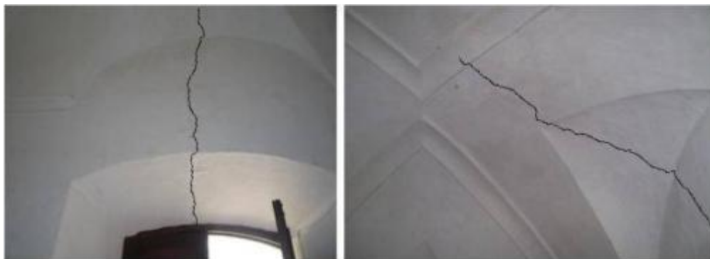
Figura 12. Sector de habitación D9 con fisuras
