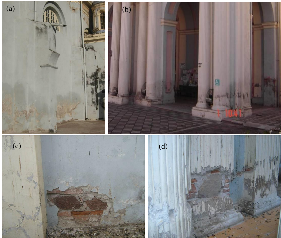
Figura 2. (a) y (b) Humedad en muros de fachada; (c) y (d) deterioro de revoques y mampuestos por el proceso de humedecimiento y secado.
