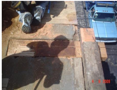
Figura 16. Arrastre de cerramiento sobre muro de mampostería.
