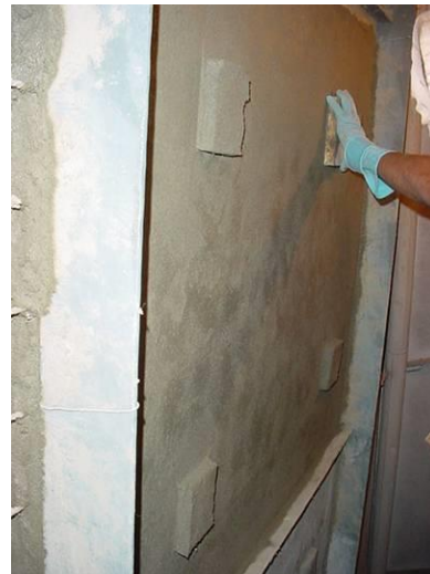
Figura 6. Tela com revestimento de argamassa. (Fonte: Arquivo da Equipe do Projeto de restauro do MNBA)
